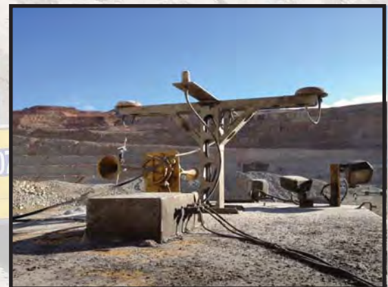
NAV Module & GPS Antennas
